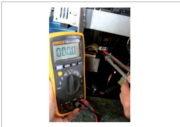
Abb. 59: Messung des Transformators
