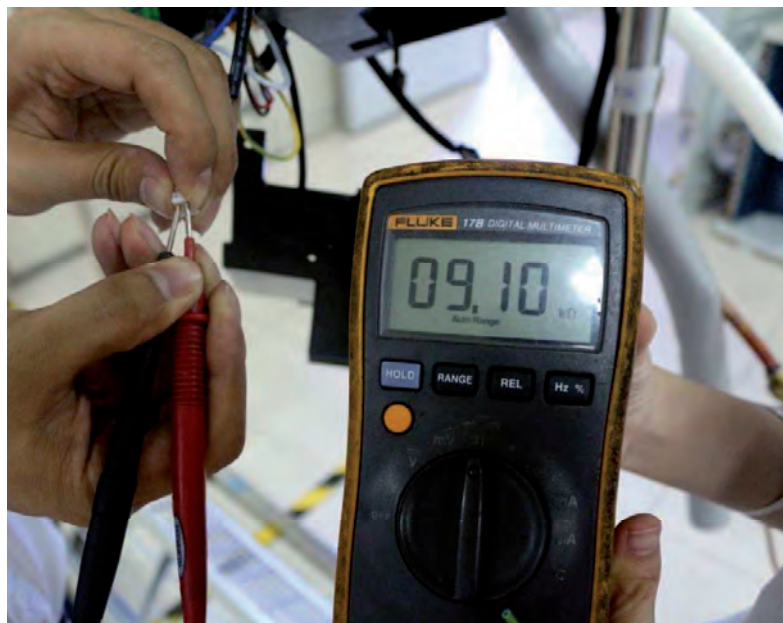
Abb. 61: Überprüfung der Sensoren
